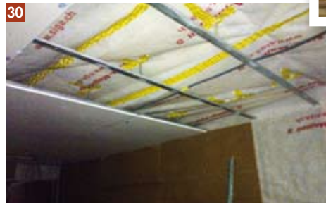
30 - Une fois l'isolation de la toiture effectuée dans le bâtiment dédié aux chambres, des rails de métal sont posés : ils permettront de visser la plaque de plâtre formant le plafond.
